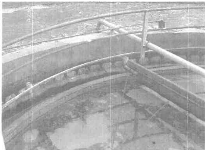
Particolare del rullo di sostegno del raschiatore superficiale e del labbro in gomma, entrambi in condizioni obsolete e pertanto da sostituire.
